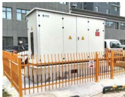
配电箱无景观遮挡
