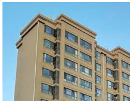
白色落水管裸露在外，位于明显位置
